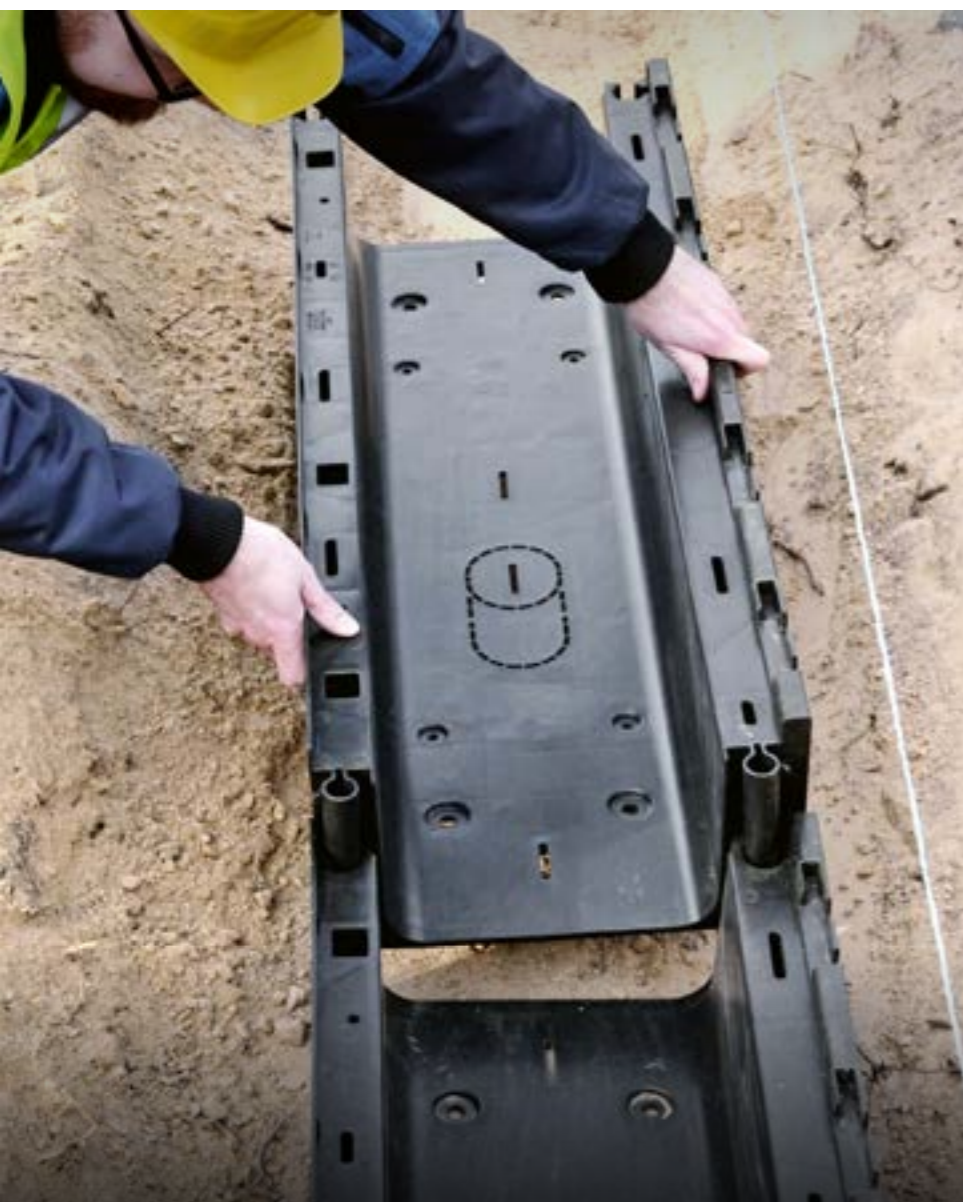
Rys. 1: Łączenie kanałów kablowych
